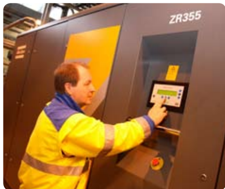
Projektledare Christer Ewerlöf vid en av de nya kompressorerna.
