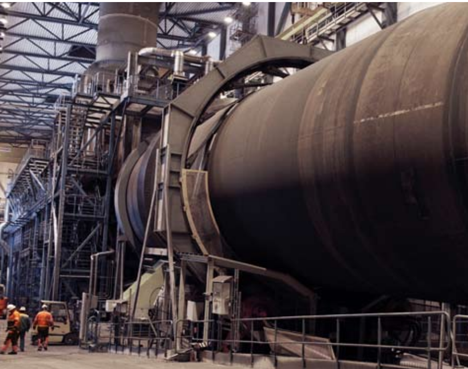
Pelletsen förvaras tillfälligt utanför verket i samband med drifts av processen. Nedre bilden visar verkets inre med kilnen, en stor roterande ugn där järnmalmspelletsen "gräddas".
